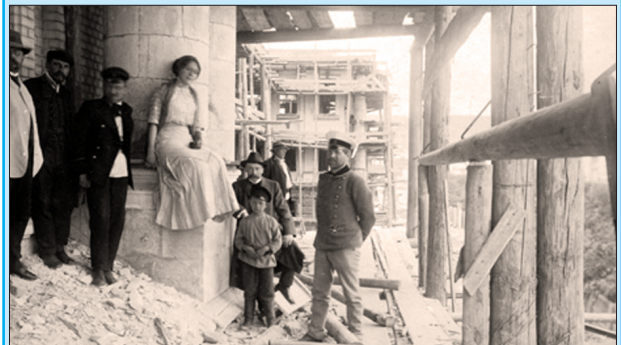
На лесах строительства I учебного корпуса Императорского николаевского саратовского университета. Фото 1912 г.
