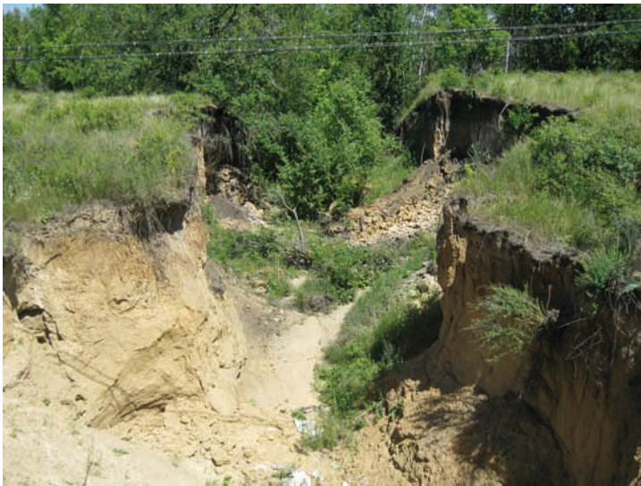
Рис. 1. Вновь образованный овраг в районе села Медяниково в Воскресенском районе Саратовской области вдоль автомобильной дороги Синодское - Воскресенское, возникший в результате неверно построенного водосборного коллектора под дорожным полотном (2013 г.)
