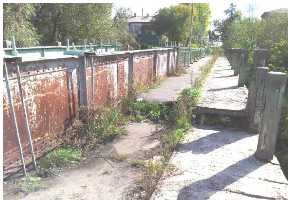
Рис. 3. Проржавевшие металлические конструкции
