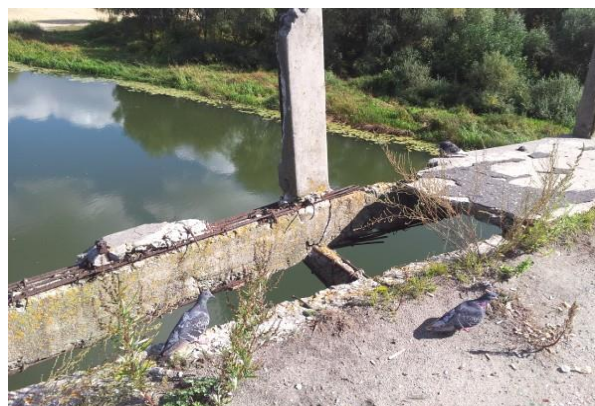
Рис. 2. Стяжки разломившегося сооружения
